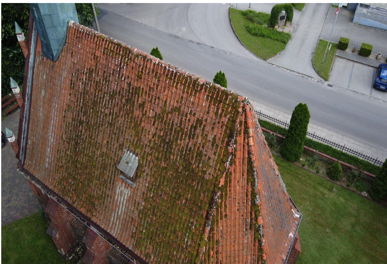
Zdjęcie nr 6 – Zabrudzenia poszycia dachu
