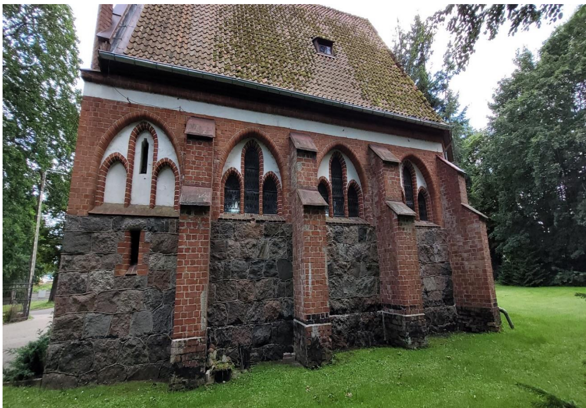
Zdjęcie nr 1 – Elewacja północna z licznymi uszkodzeniami przypór w strefie cokołowej
