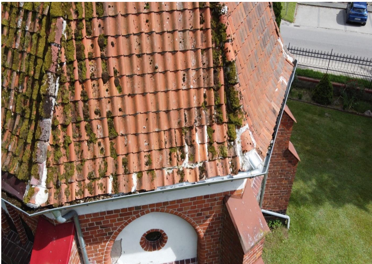
Zdjęcie nr 9 – Zniszczone dachówki i gąsiory
