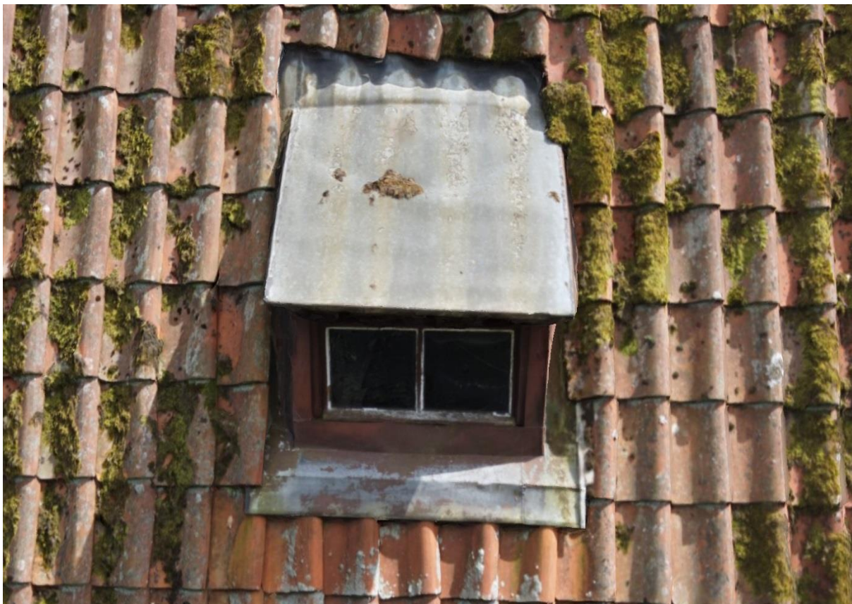
Zdjęcie nr 7 – Zniszczona lukarny i stolarka okienna
