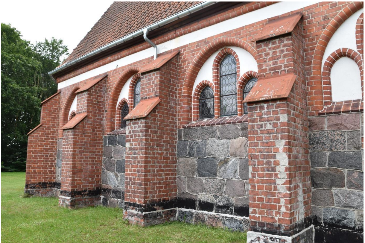
Zdjęcie nr 3 – Uszkodzenia i zabrudzenia cegieł cokołu, pilastrów i pokryw
