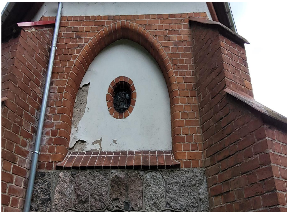
Zdjęcie nr 2 – Uszkodzenia tynku blendy okiennej na ścianie prezbiterium
