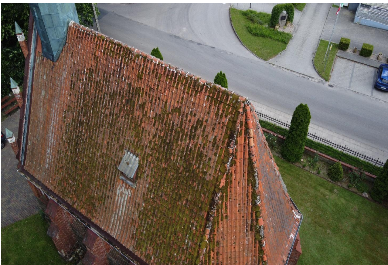
Zdjęcie nr 6 – Zabrudzenia poszycia dachu
