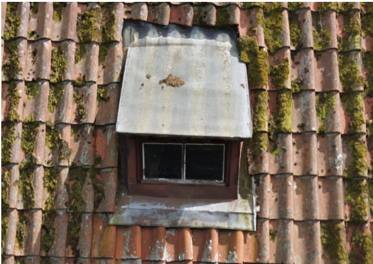
Zdjęcie nr 7 – Zniszczona lukarny i stolarka okienna
