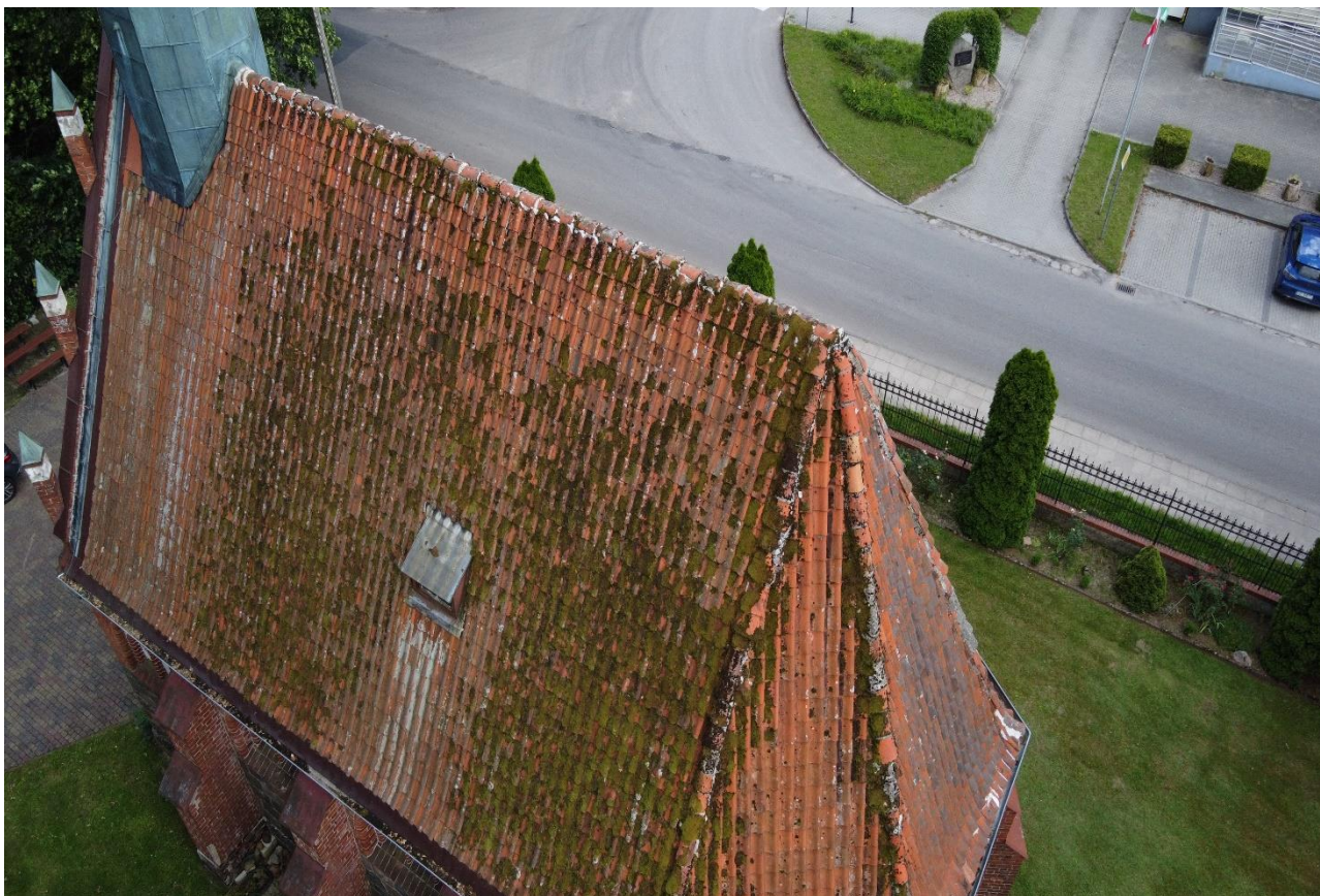
Zdjęcie nr 6 – Zabrudzenia poszycia dachu
