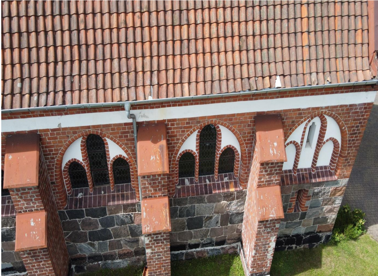
Zdjęcie nr 10 – Zniszczone obróbki pokryw przypór, zabrudzone parapety klinkierowe
