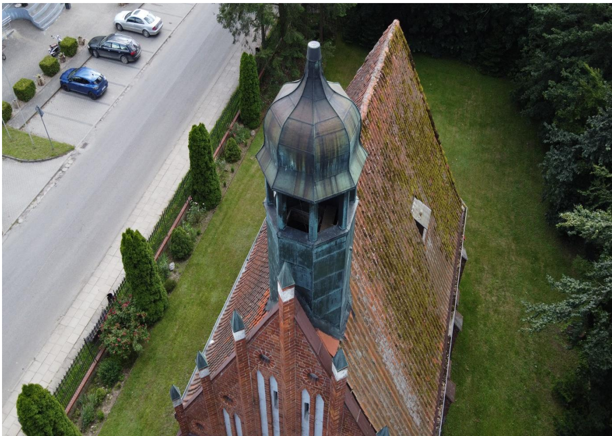
Zdjęcie nr 5 – Dach z sygnaturką widok ogólny – brak iglicy, zabrudzenia dachówki
