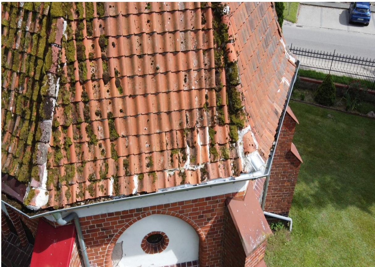
Zdjęcie nr 9 – Zniszczone dachówki i gąsiory
