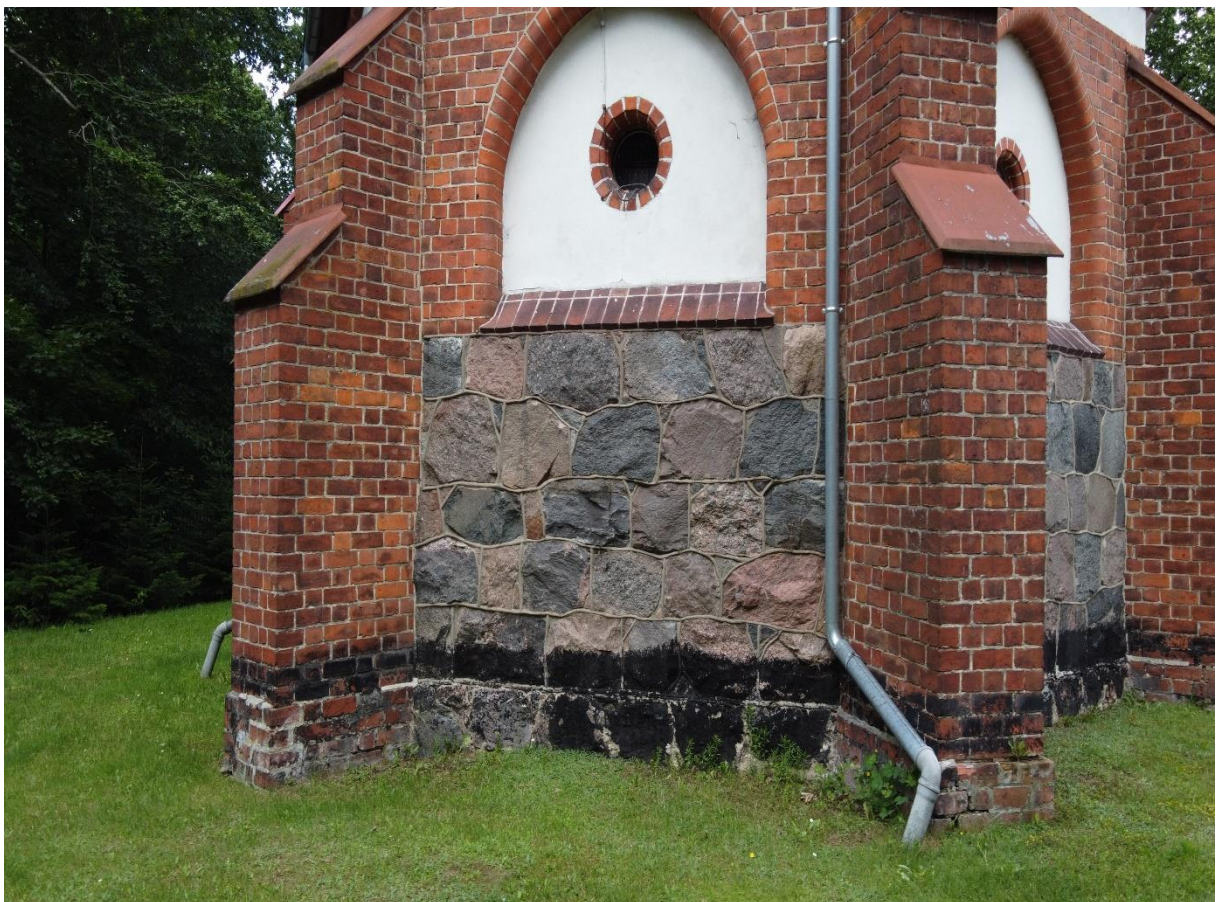
Zdjęcie nr 4 – Uszkodzenia cegieł pilastrów w strefie cokołowej
