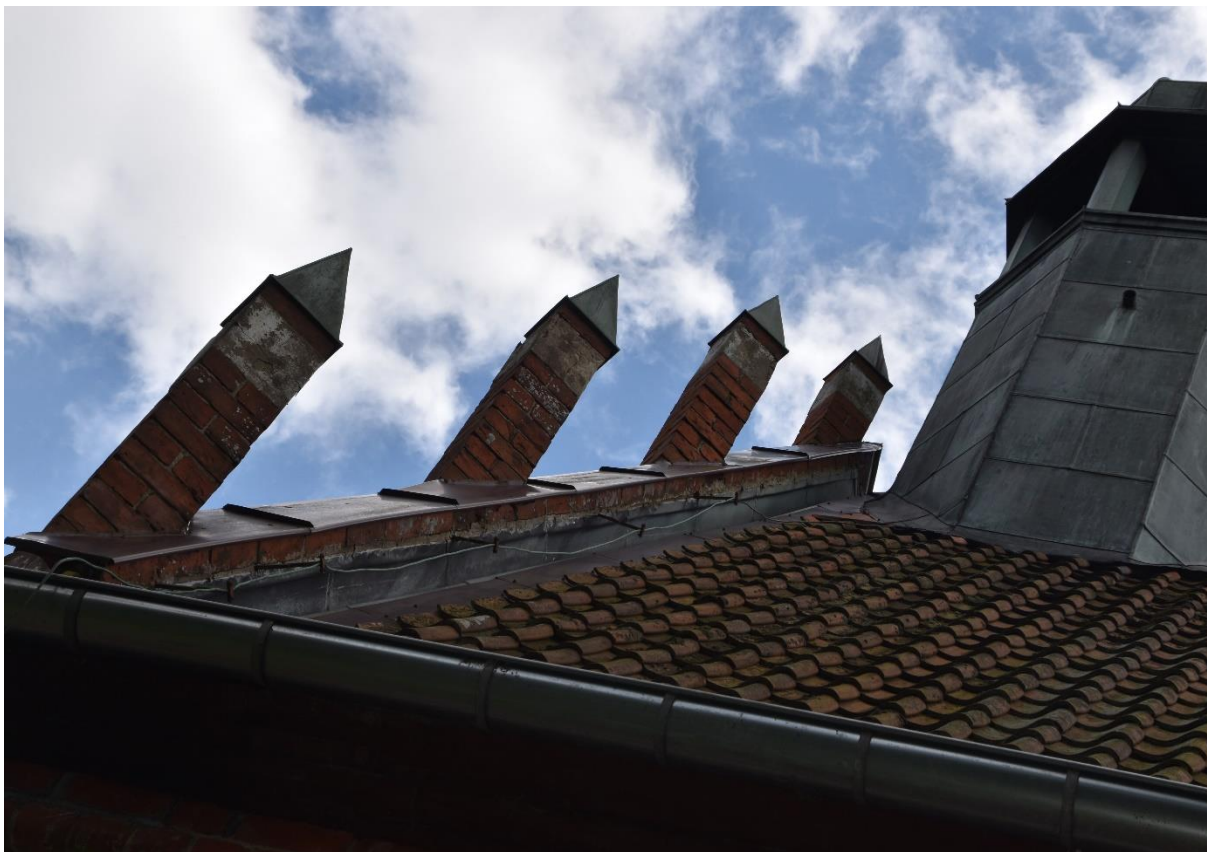
Zdjęcie nr 11 – Obróbka blacharska dachu na połączeniu ze ścianą frontową
